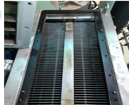
Wärmetauscher, 2 Jahre Betrieb, kein Fouling
