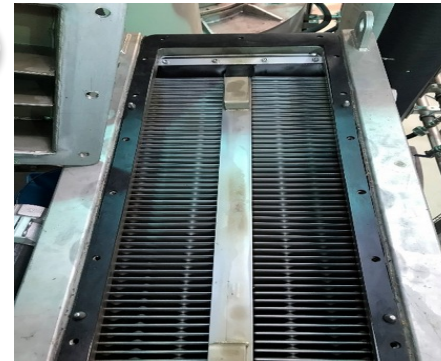
Wärmetauscher, 2 Jahre Betrieb, kein Fouling
