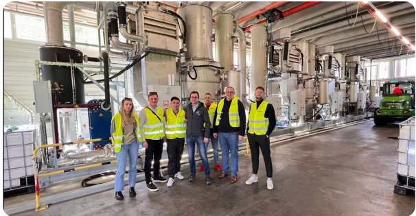
El evaporador DV in situ, durante una visita de clientes
