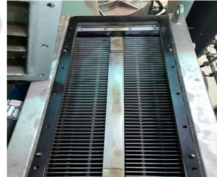
Intercambiador de calor, 2 años de operación, sin incrustaciones
